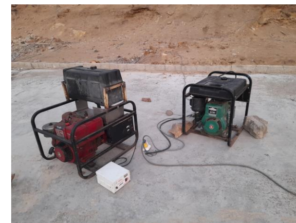
Generadores eléctricos, en caso de no contar con energía eléctrica disponible en la zona
