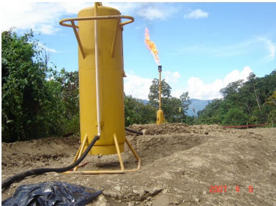
En la foto se observa el TK de choque en donde se separan los líquidos de los gases provenientes de la tubería averiada, los líquidos son almacenados y los gases son quemados en el flare.
