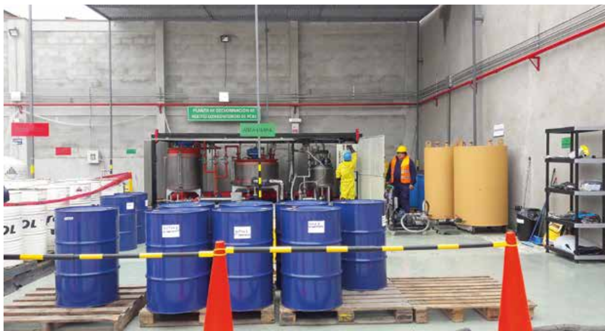
Foto N° 14: Planta de decloración en funcionamiento
