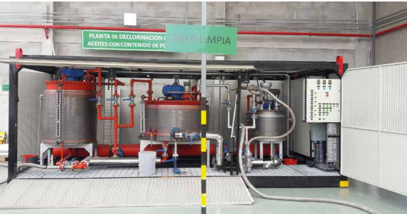
Foto N° 8: Declorinadora de la empresa TREDI S.A.
