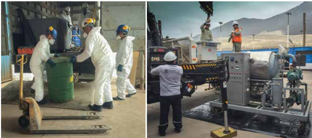
Foto N° 19: Manejo de transformadores con PCB
